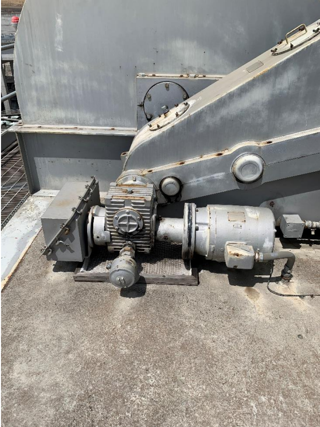
Figure 1. Spill gate 3 motor
